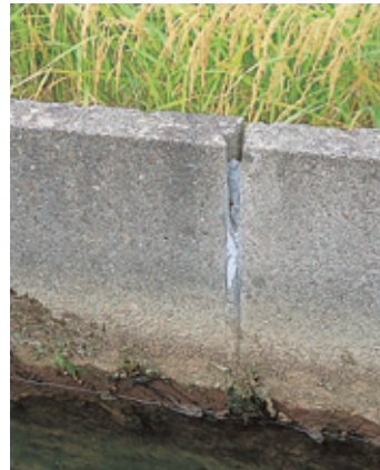
劣化して崩れたモルタルの目地
